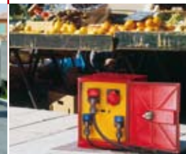
Colonnine per la distribuzione di servizi
